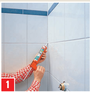
Dauerelastische Verschluss der Eckfuge.
