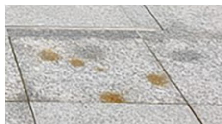
Rostfläckar på grund av främmande föremål (bild 2)
